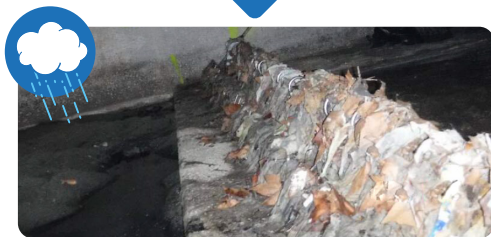
Fig. 10 - Reixes de retenció de sòlids flotants.
